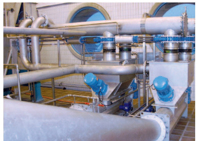
HUBER Vesikourujärjestelmän alla HUBER WAP/SL välpepesureita.
